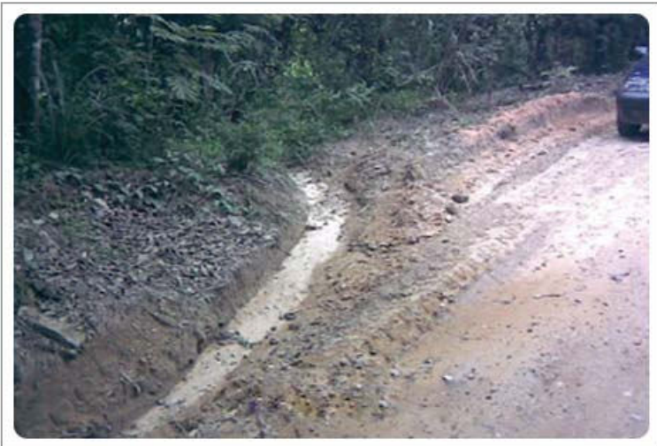
Foto mostrando situação de escoamento que pode dar origem a processo de erosão.
