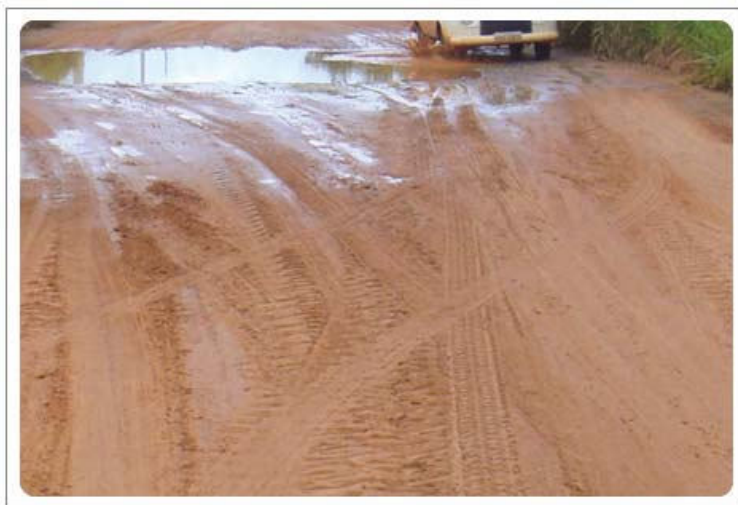
Estrada mostrando a falta de drenagem para escoar as águas das chuvas da plataforma
