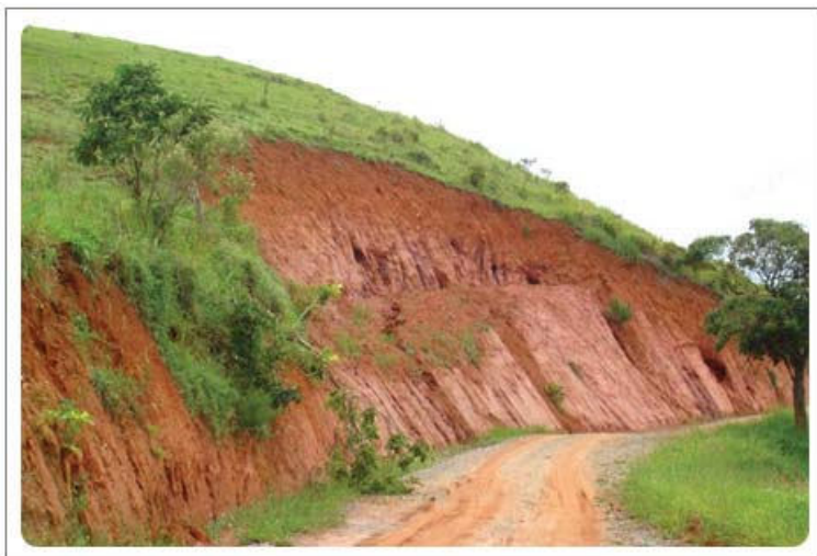
Foto mostrando queda de barreira provocada pela falta de conservação do solo, em área de contribuição da estrada
