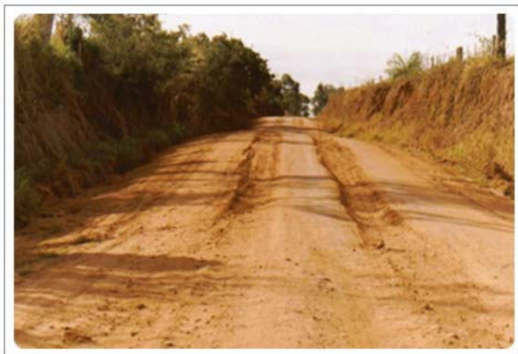
Foto mostra o aparecimento de trilhas de rolagem provocadas pela falta de manutenção da estrada rural.
