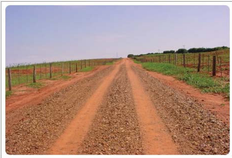
Foto mostrando segregação de material aplicado, evidenciando desperdício
