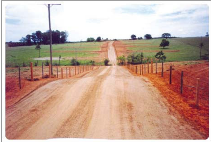
Foto mostra lombadas para direcionar as águas das chuvas para fora do leito de rolamento
