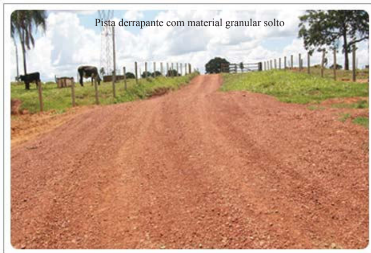
Foto acima mostra o excesso de material granular aplicado, dificultando o tráfego de veículos .
