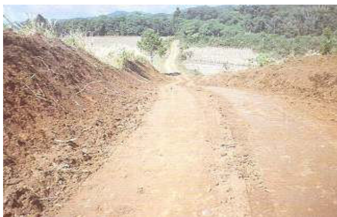
Figura 9: perda de agregados (Fonte: Baesso e Gonçalves, 2003)
