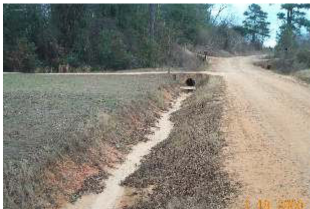
Figura 19: exemplo de uma sarjeta em ótimo estado (Fonte: Ken Skorseth, 2000)
