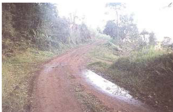
Figura 4: drenagem inadequada (Fonte: Baesso e Gonçalves, 2003)
